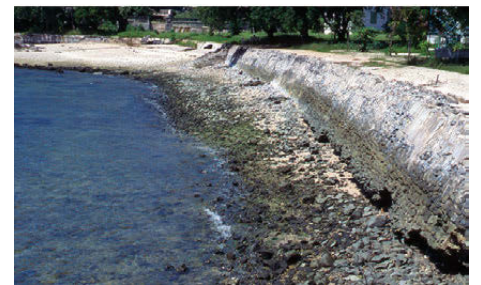
写真2：1995年には砂浜が消滅していた。
